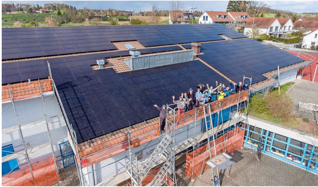
Für das Foto rückte man kurz zusammen. Die neue Fotovoltaikanlage auf der Mehrzweckhalle in Hettlingen ist fertig. Foto: PD
