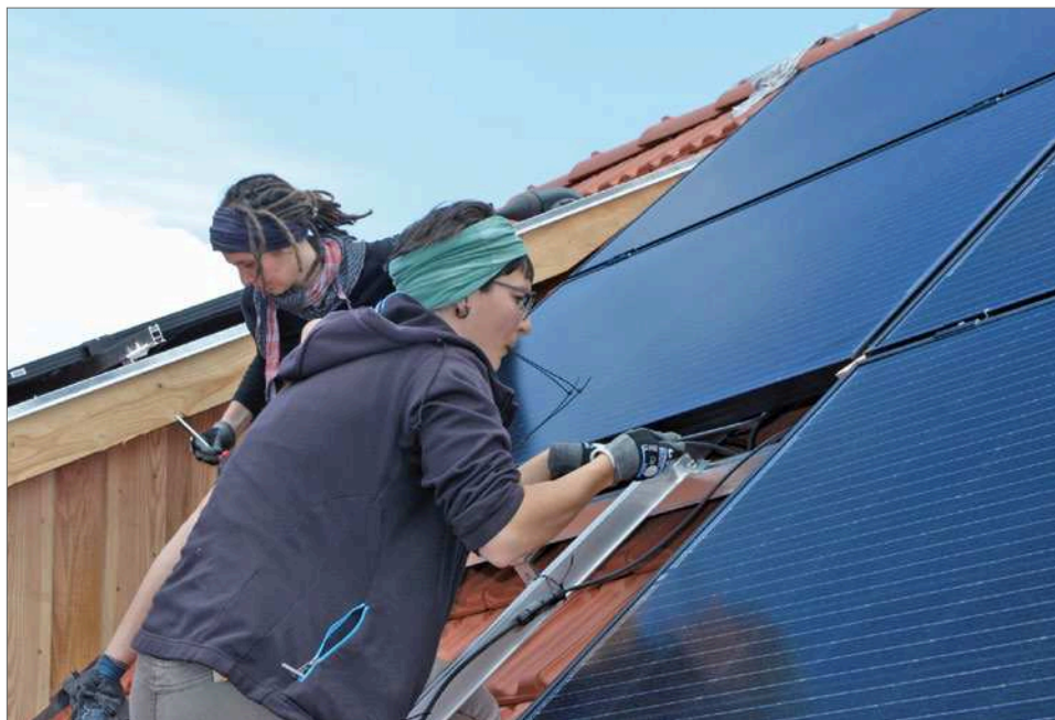
Bild: SoLocal Energy
