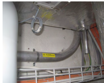
PV-Gleichstromleitung in komplett geschlossener Alu-Rohrleitung inkl. Kennzeichnung
